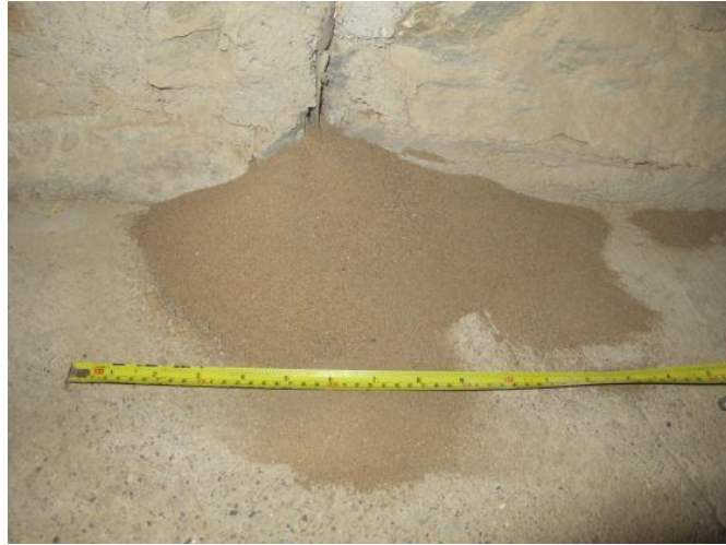
图 3-7 第 116 窟加固墙缝隙漏沙成堆
