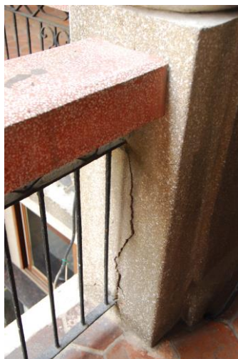
图 3-14 杨家园鼓新路 29 二层栏杆立柱开裂
