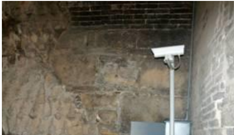
图 3-8 擂鼓台南洞渗漏水
