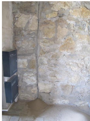
图 3-8 第 180 窟加固墙缝隙漏沙
