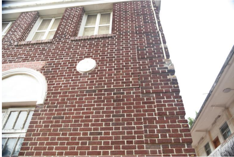
图 3-12 美国领事馆墙面裂缝 1
