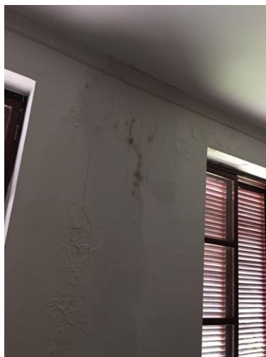
图 4-16 海关副税务司 11 号楼 2 层渗水
