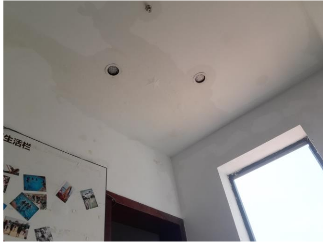
图 4-7 番婆楼三楼侧楼阳台入口处漏水
