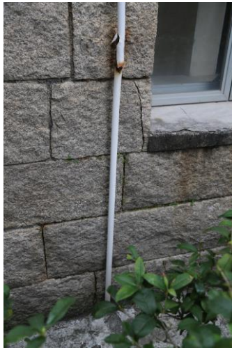
图 3-19 安献楼南立面墙体表面沿砖缝通裂
