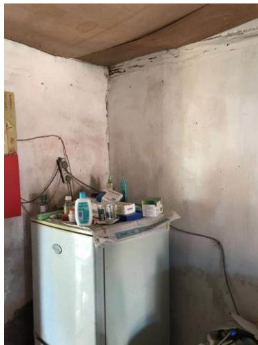
图 4-22 黄氏小宗多处漏水
