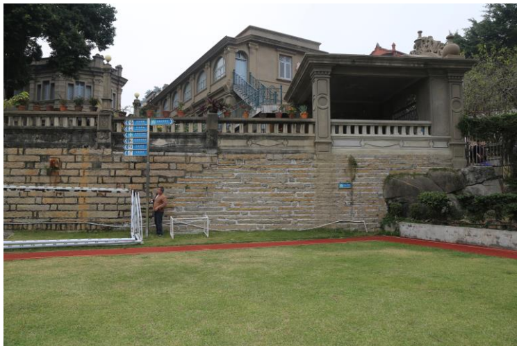
图 3-21 洋人球埔旧址看台不均匀沉降不均匀沉降
