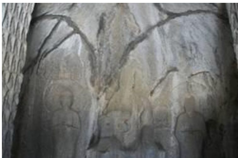
图 3-12 双窑南洞凝结水病害监测
