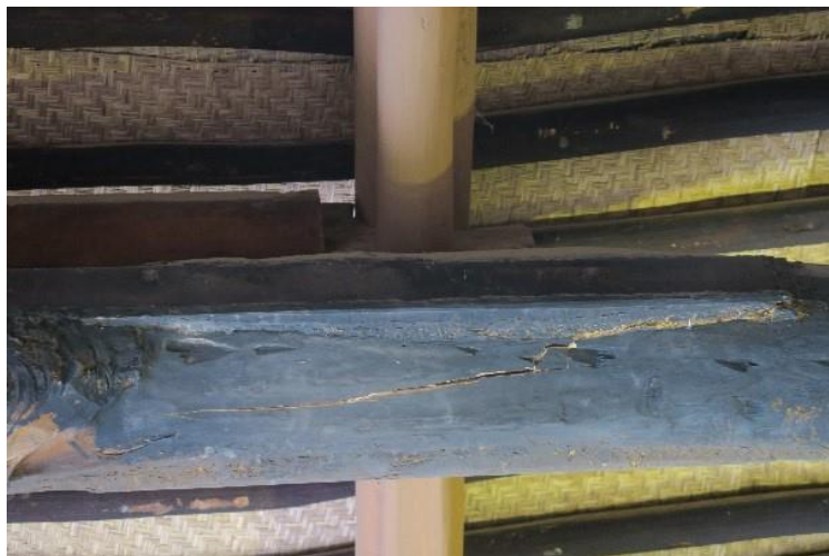
图 3-3 第 94 窟前室北侧纵向大梁开裂
