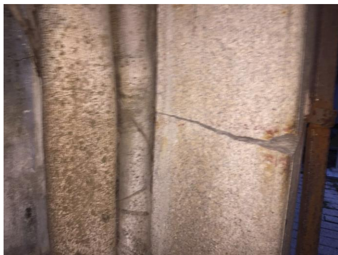
图 3-15 黄荣远堂门楼柱子开裂
