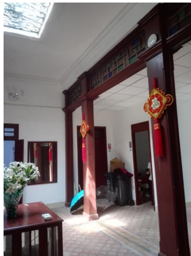
图 4-8 海天堂构 40 号楼二楼楼梯口右前方天窗右侧漏水
