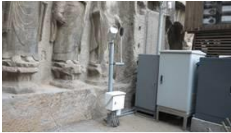
图 3-25 奉先寺顶部渗漏水监测
