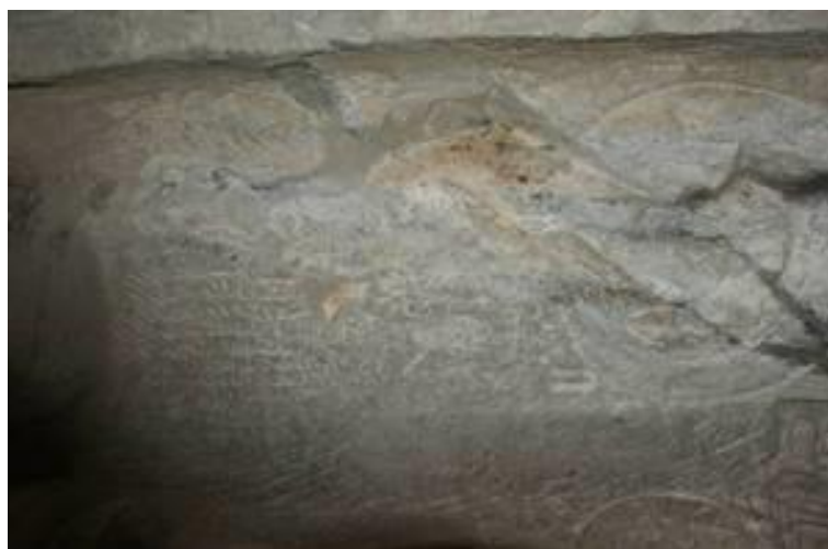
图 3-11 双窑北洞凝结水病害
