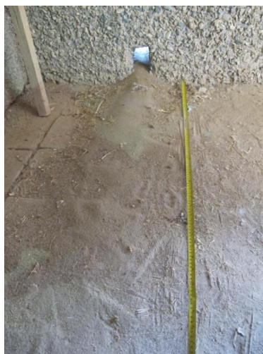
图 3-10 北区南湖店西 22 窟东壁北侧下方通风孔处地面堆沙
