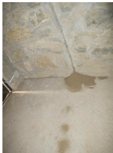
图 3-6 第 116 窟加固墙缝隙漏沙
