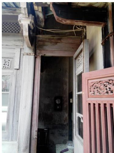
图 4-23 四落大厝中华路 23 号多处漏水
