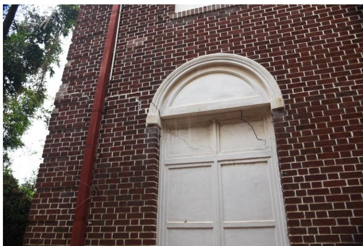
图 3-10 美国领事馆墙面裂缝 2
