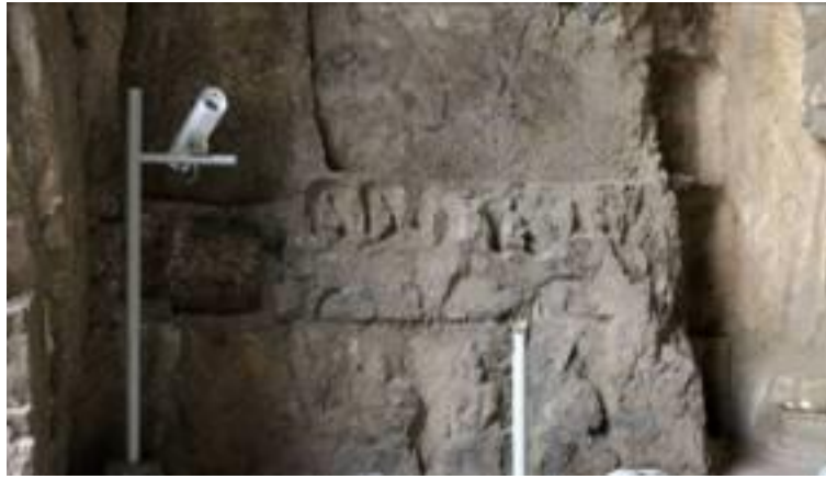
图 3-13 宾阳北洞渗漏水监测
