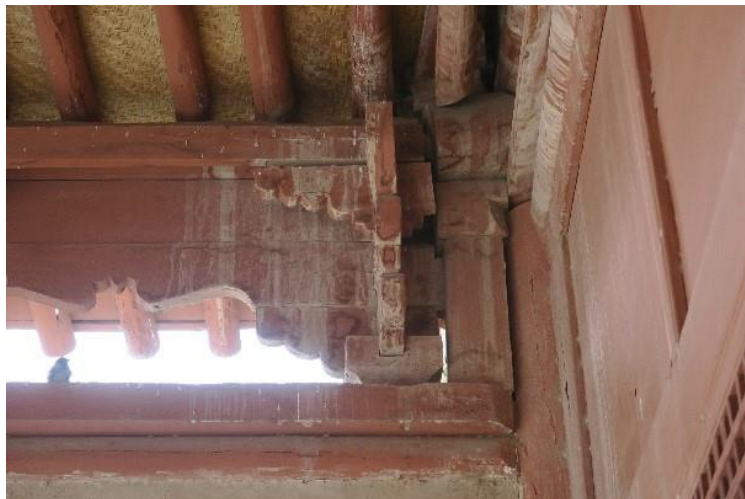
图 3-5 第 94 窟前室外锚固件脱锚
