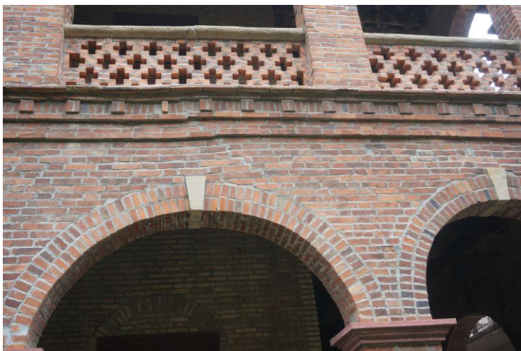
图 3-22 毓德女学（田尾路 14 号）栏杆断裂
