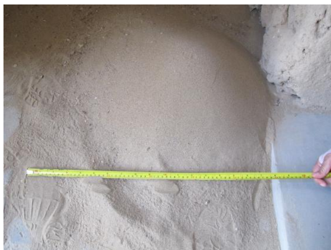
图 3-9 第 180 窟加固墙与崖体间缝隙漏沙严重
