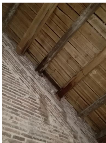
图 4-14 三一堂 2 楼阁楼西侧局部漏水
