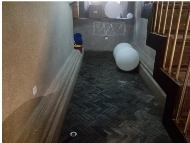
图 4-10 海天堂构 34 号虫洞书店一楼楼梯口后侧漏水
