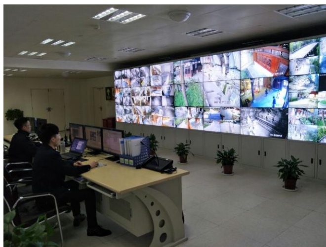
图 5-17 大足石刻安防监控室
