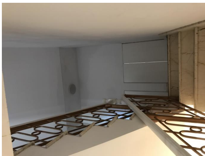
图 4-24 英商亚细亚火油公司旧址漏水
