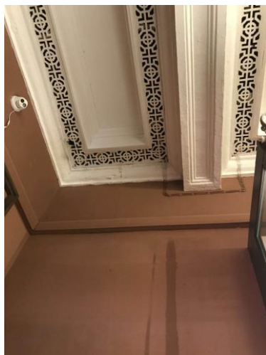
图 4-19 黄荣远堂 2 楼漏水
