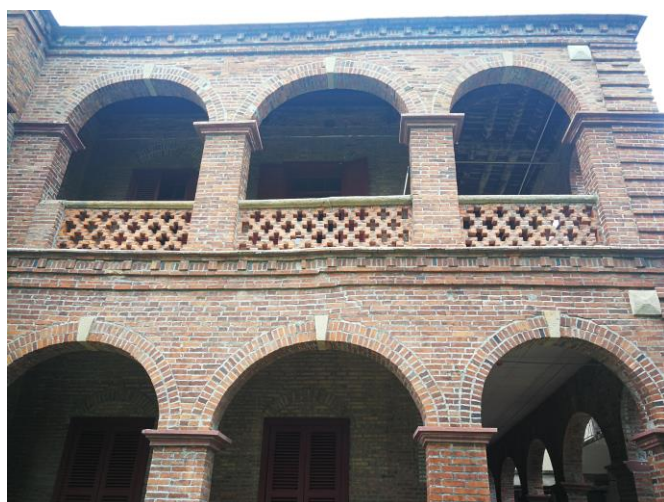
图 3-24 毓德女学（田尾路 14 号）立面扭曲开裂
