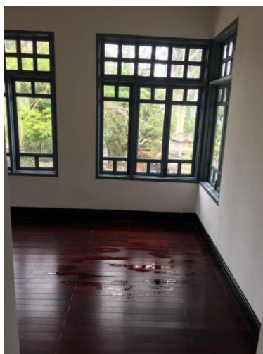
图 4-18 毓德女学校漏水
