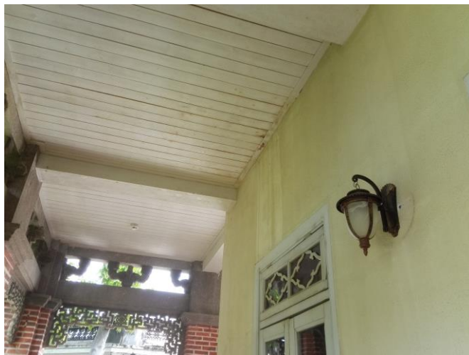
图 4-9 海天堂构 38 号楼二楼后侧漏水
