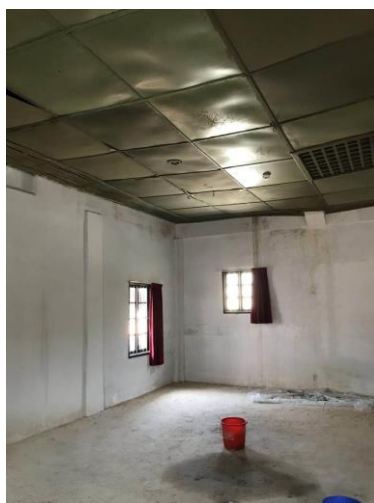
图 4-21 延平戏院 2 楼漏水
