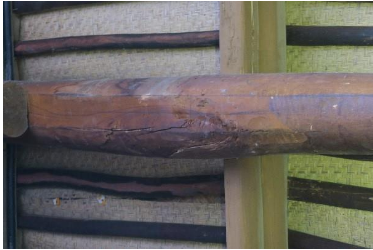
图 3-4 第 94 窟前室南侧纵向大梁开裂
