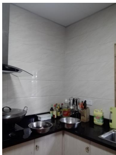
图 4-15 吴添丁阁厨房位置漏水
