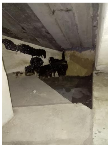
图 4-11 日光岩寺弥陀殿 2 楼隔层漏水
