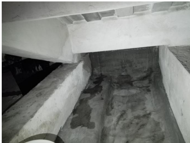
图 4-13 日光岩寺弥陀殿 2 楼漏水
