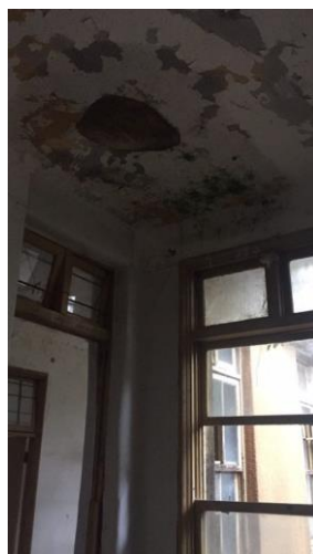
图 4-17 博爱医院多处渗漏
